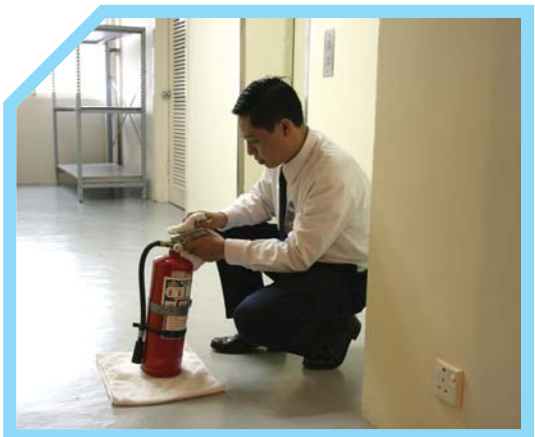
KIỂM TRA BÌNH CHỮA CHÁY 9
