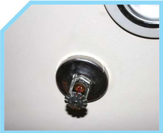
HỆ THỐNG VÒI PHUN NƯỚC 3
